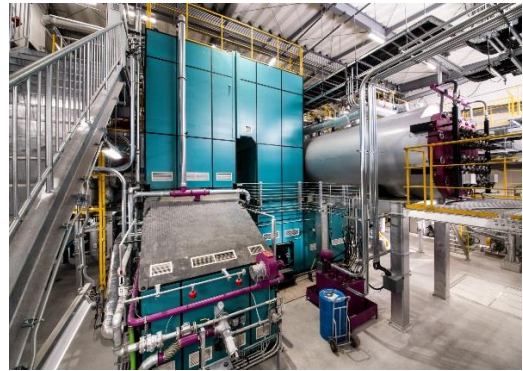
バイオマス発電プラント（ボイラ室）
