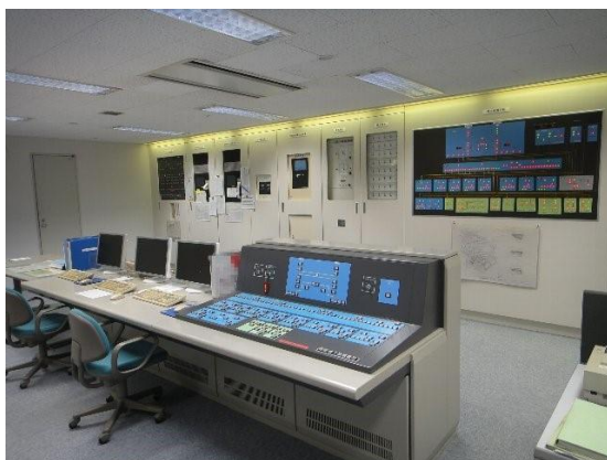
競馬場の中央監視室
